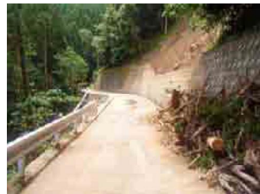
通行を確保するため農道路面上の崩落土砂を早急に撤去
