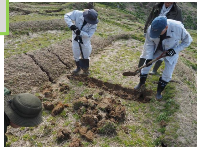
更に亀裂に土を入れる
